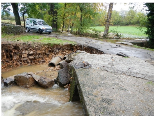
Endommagement de la voirie
